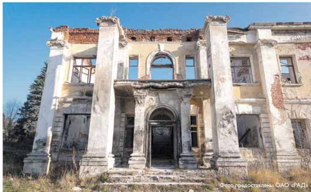
Исторические кровли пострадали от пожаров.
